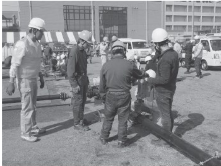
組合員の指導のもと建築設備科の学生も仮設給水栓設置訓練に参加
