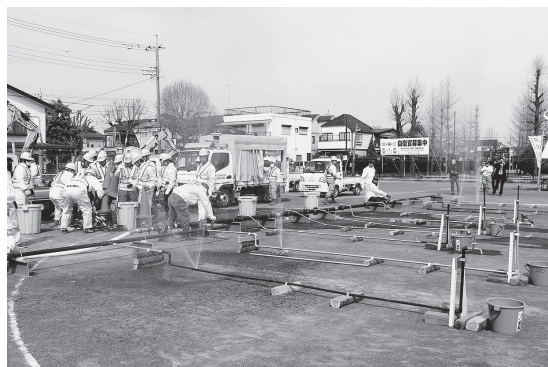
水道管から漏水しています
