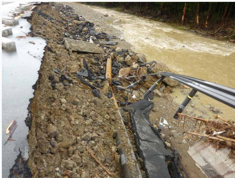
露出し破断した配水幹線1
