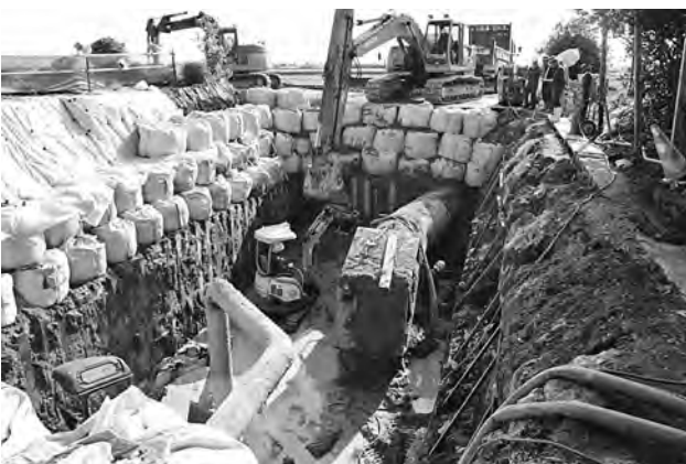
熊本市管工事協同組合(熊本市江津湖公園付近) (23頁と同じ現場)
