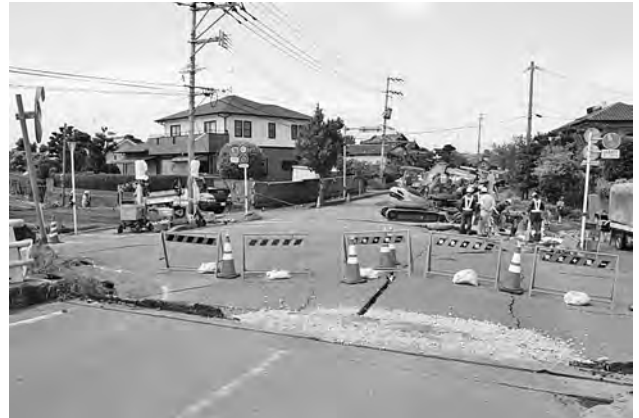
左写真と同じ現場。本震（2回目）で地割れや家屋の塀が倒れかかっている（4月17日）
